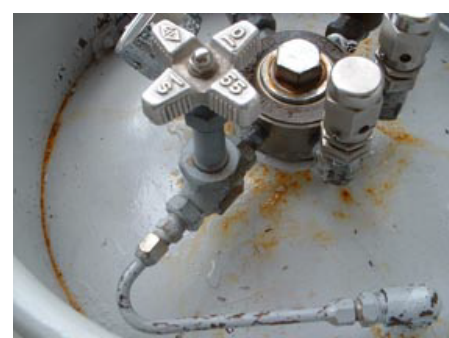
保圧弁（昇圧弁）
